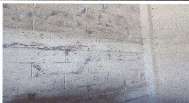
Foto 3. En muros exteriores e interiores
